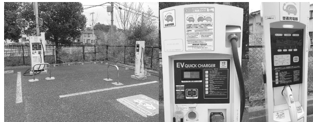
【写真1】【写真2】 スーパーの急速充電器と普通充電器
